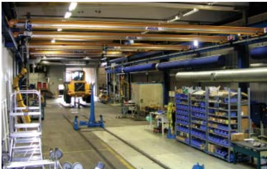
På bilden ovan ser ni det nya traverssystemet från ABUS som sattes in vid nya monteringsbanan under sommaren.
