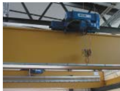
Två ELS 5-tonstraverser med spännvidder på över 25 meter.
