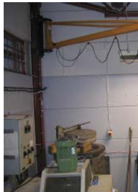
En väggsvängkran monterad på pelare. L
