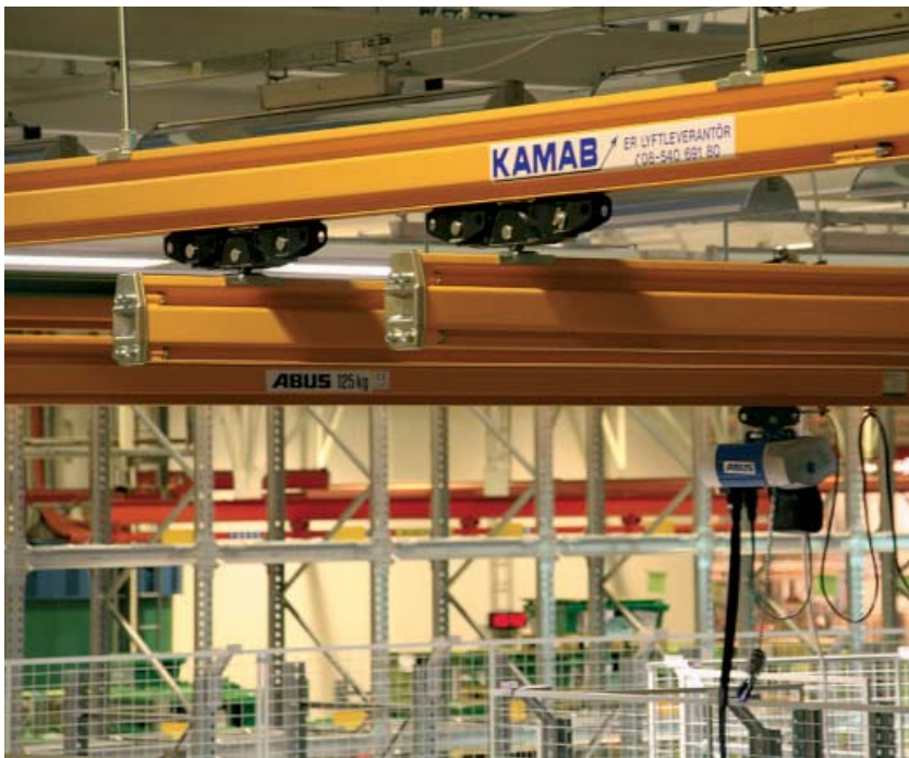
Scanias nya linje med enkelbalkstraverser, lättmetallskenor och ABUS-telfrar.
