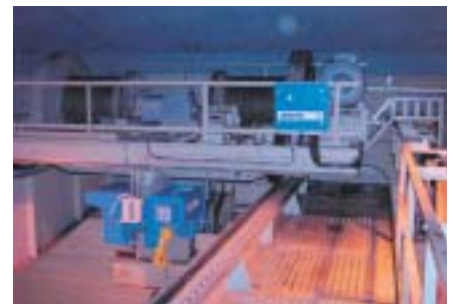
Totalrenoverad pryder den mer än 60 år gamla traversen sin plats i vattenkraftverket. Med ABUS hjälplyft samt elektronik och radiostyrning från 2000-talet har ProCranes gjort den både mer lättmanövrerad och betydligt säkrare att använda!
