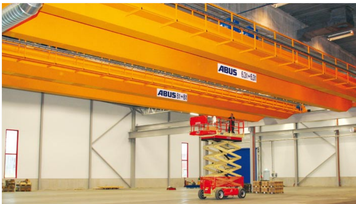
Två ABUS-traverser på 2x8 och 2x6,3 ton har installerats för att lyfta plåt i de nya lokalerna.
